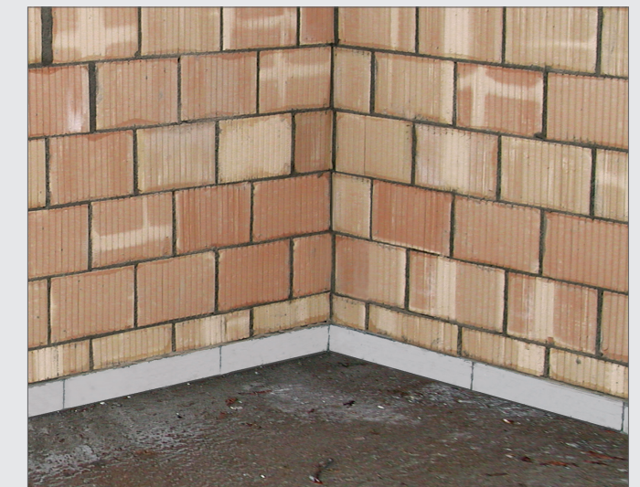
Feuchtigkeit in der Bauphase
