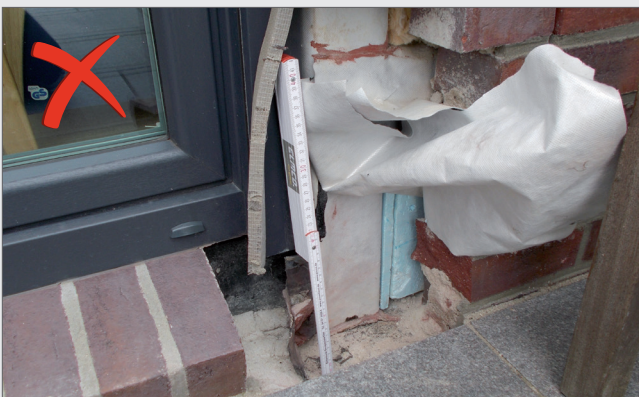
Fehlerhafte Ausführungen der Sockelabdichtung führen zu erheblichen Schäden und ziehen oft aufwändige und teure Sanierungsmaßnahmen nach sich.
