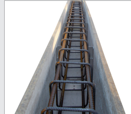
Eingebauter ELMCO – FeKo
