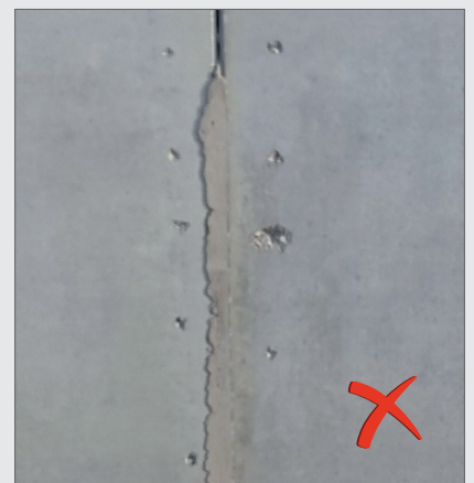
Ausbrüche nach Entfernen von Brettern
