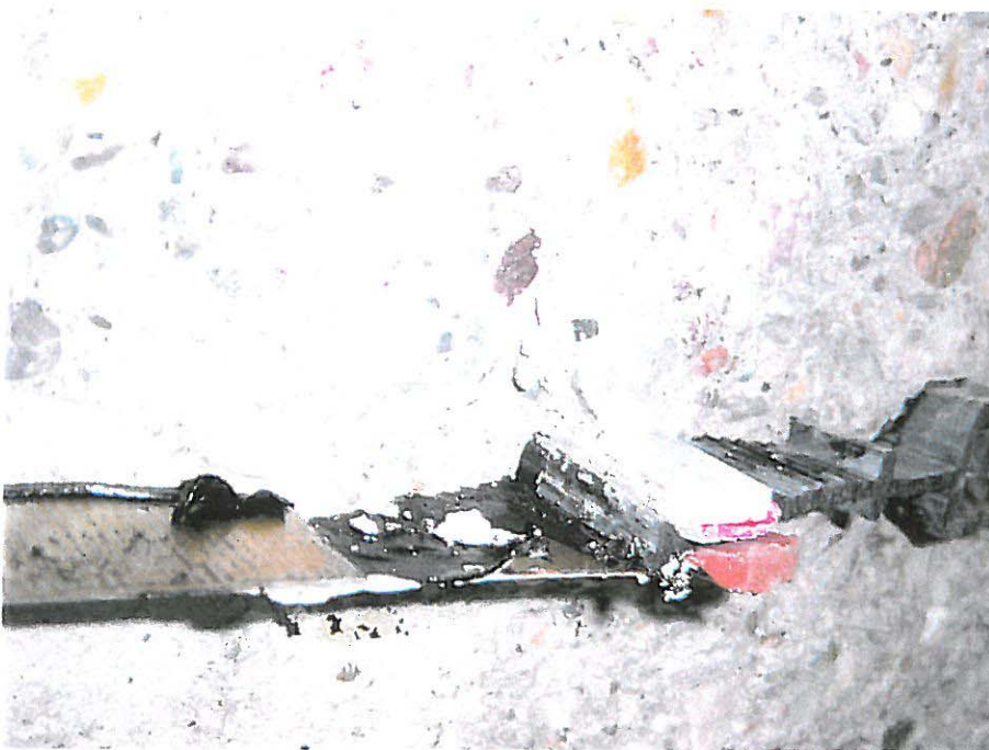
Bild 6: Im Rahmen verbliebene Abdichtung aus Fugenblech, Fugenelement und Fugenband
