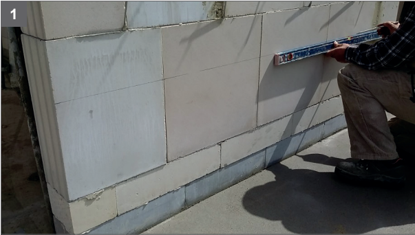
1 Anreißen der Höhe auf Hintermauerwerk, je nach Wandlänge mit Richtscheit / Wasserwaage oder Schlagschnur
