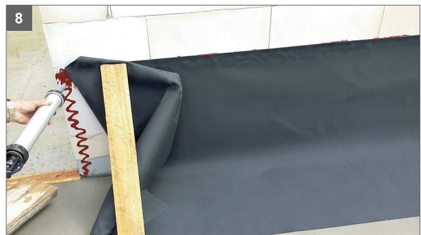
8 Die Folie muss umlaufend (Seiten und Bodenplatte) mit dem Untergrund auf die gleiche Weise wie oben beschrieben verklebt werden
