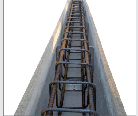
Eingebauter ELMCO – FeKo
