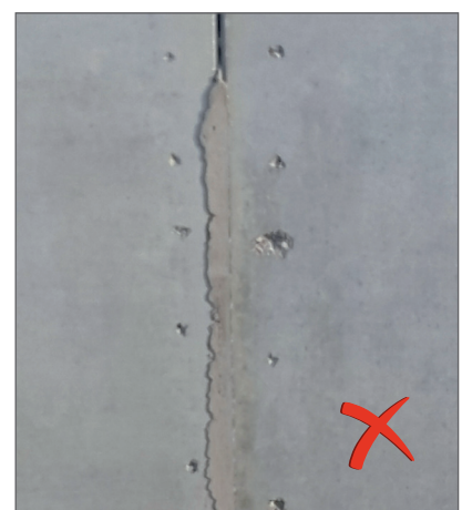
Ausbrüche nach Entfernen von Brettern
