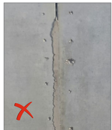
Ausbrüche nach Entfernen von Brettern
