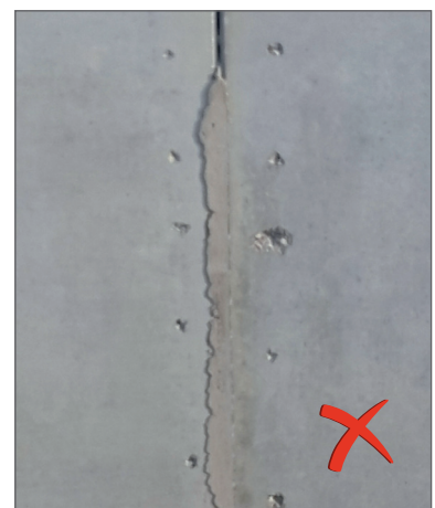
Ausbrüche nach Entfernen von Brettern
